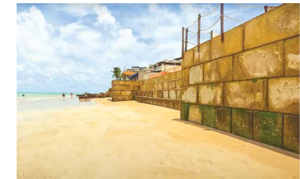
Órgãos concluíram que parte do muro de contenção ultrapassou o limite do lote da obra
