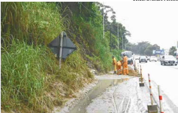
Via foi liberada rapidamente pela Semob-JP, após queda de árvore
