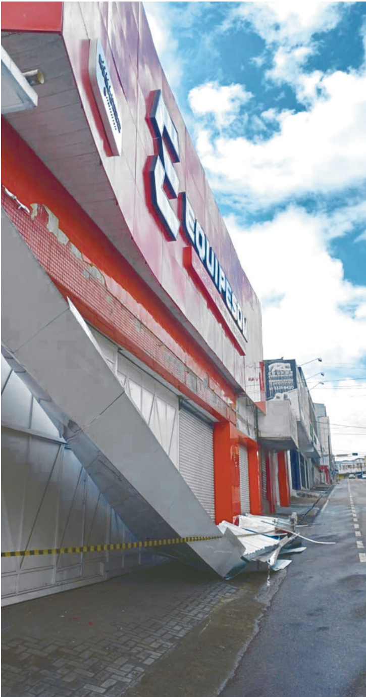
No Centro de Campina Grande, uma estrutura metálica de uma empresa desabou (à es.). A Defesa Divil está monitorando passagens molhadas
