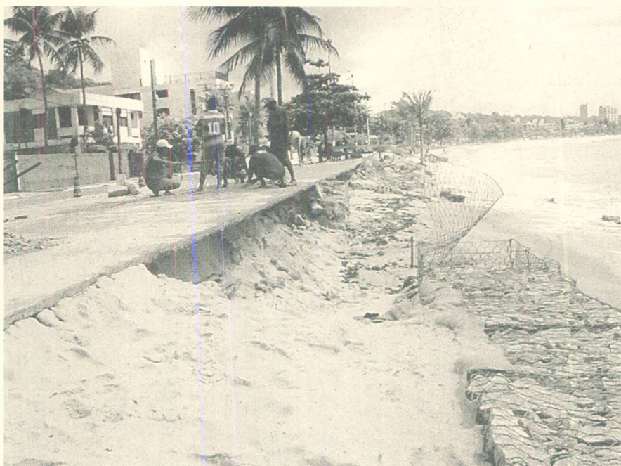
AVANÇO Ondas têm causado destruição no calçadão da praia do Cabo Branco
