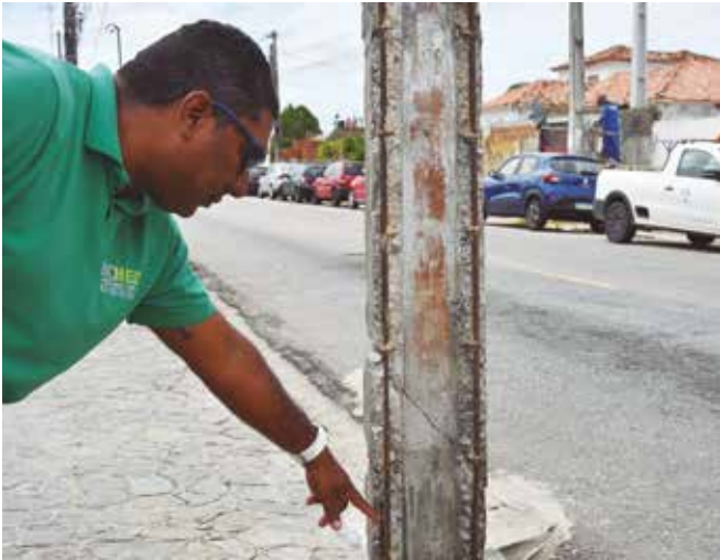
Cleverton mostra as fissuras e o desgaste do poste em Tambiá
